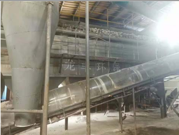
旋风除尘器、封闭传送带
