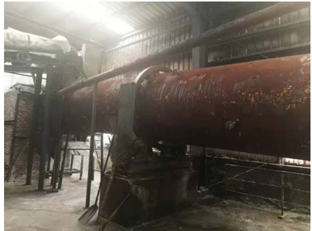
烘干机、燃烧室
