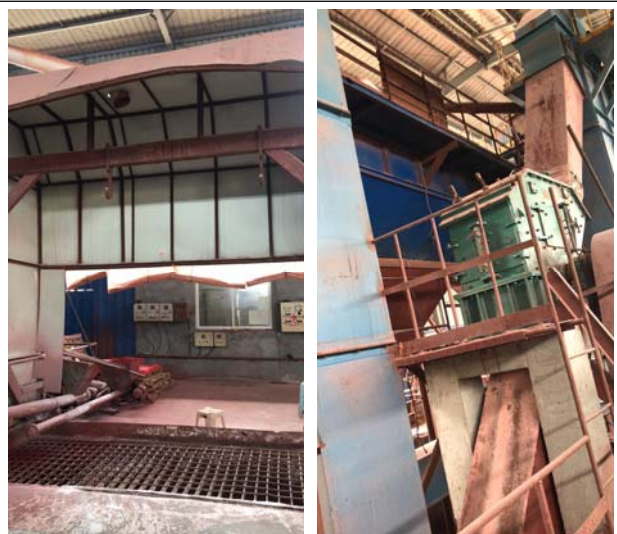
进料半封闭，提升机封闭
