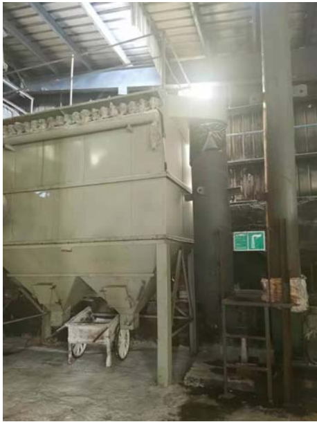
袋式除尘器、排气筒标识、采样口
